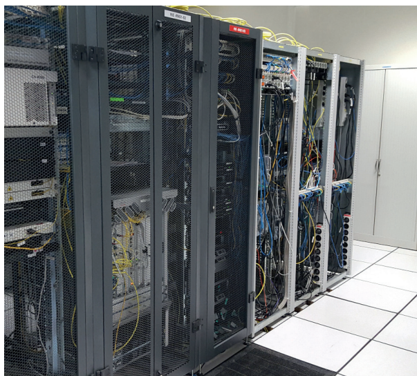
Transfert des flux depuis les baies RGT (à droite) vers des baies RIE (à gauche) au centre d'exploitation de Rennes
